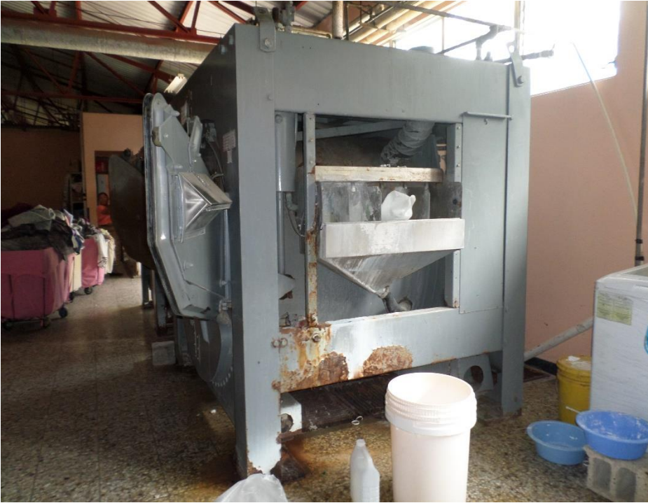
Lavadora en mal estado
